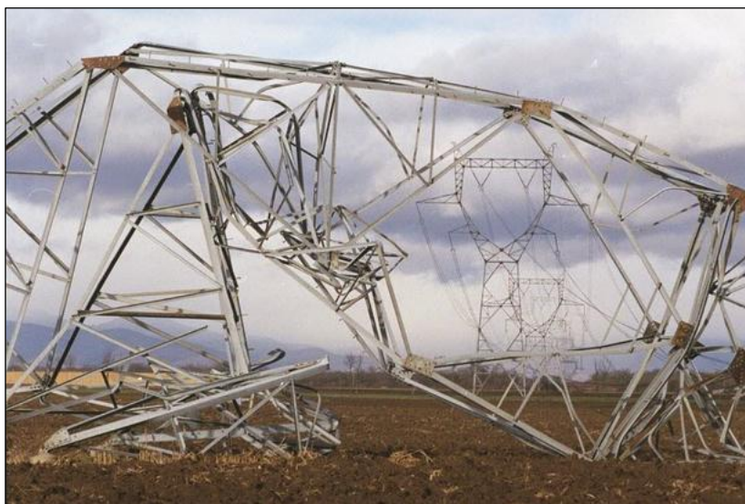
Figure 14 : un pylône électrique à haute tension victime de la tempête Lothar à Dessenheim (Haut-Rhin).
